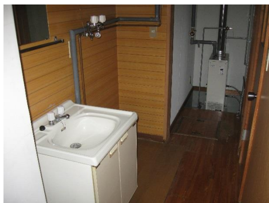
洗面所・洗濯機置場・給湯器
