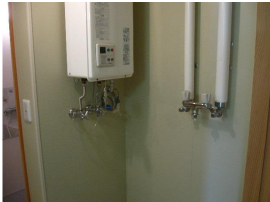
給湯器・洗濯機置場
