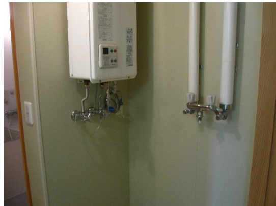
給湯器・洗濯機置場
