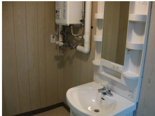
洗面所・給湯器
